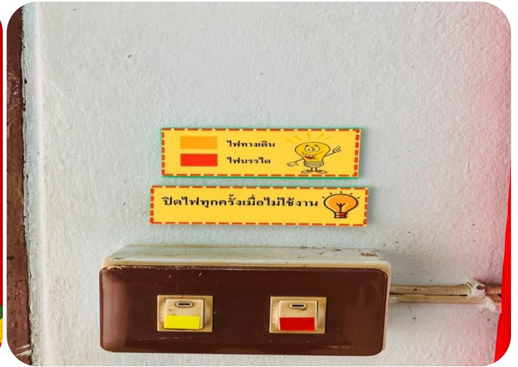
สวิตช์ไฟเปิด-ปิด ให้มีป้ายระบุให้ชัดเจน
