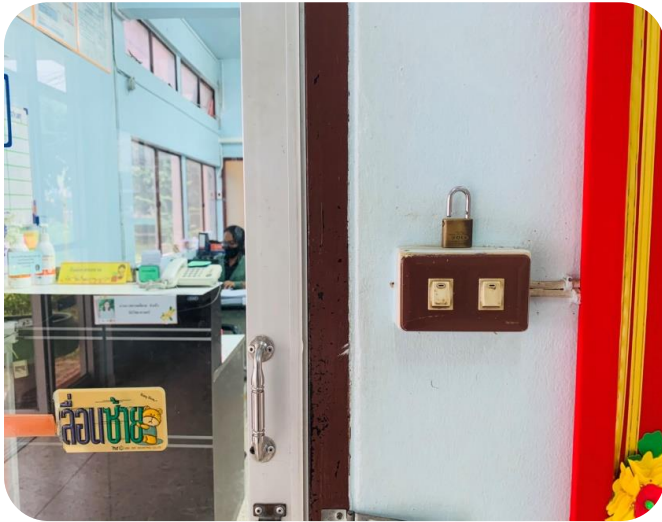
สวิตช์ไฟเปิด-ปิด ให้มีป้ายระบุให้ชัดเจน
